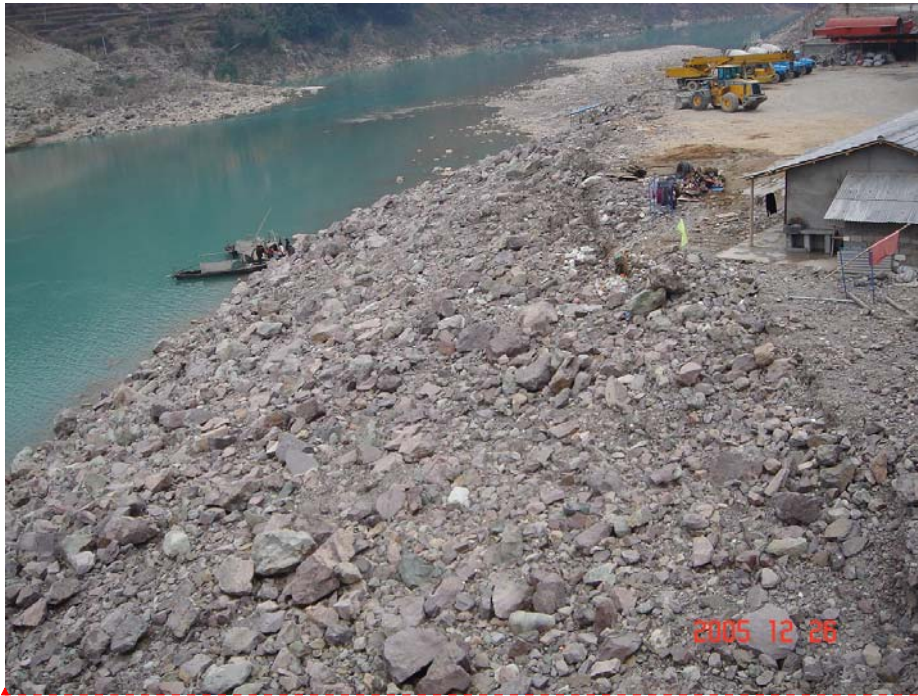
四局营地堆渣现状
